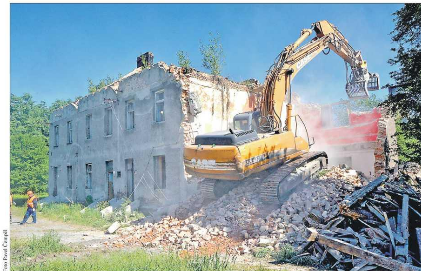
Bohumínská radnice za posledních deset let zbourala v pěti problémových lokalitách 18 vybydlených domů.
